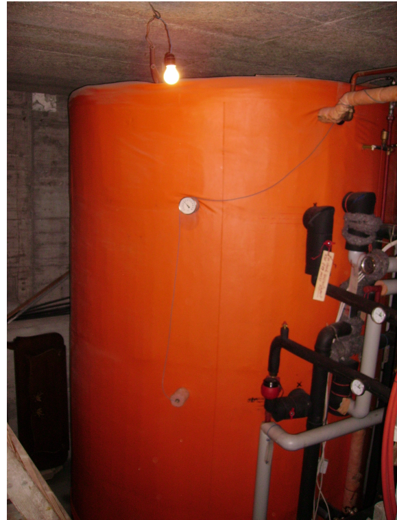
La cuve de 11 000 litres se trouve sous le séjour, sa mise en place relève de l'exploit.
